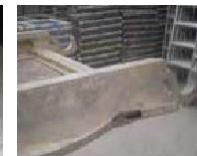
Lavan pinta vaurioitunut
