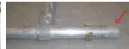
Sivusuojakaiteen kehyksen alaosan kohdalla ei ole holkkia
